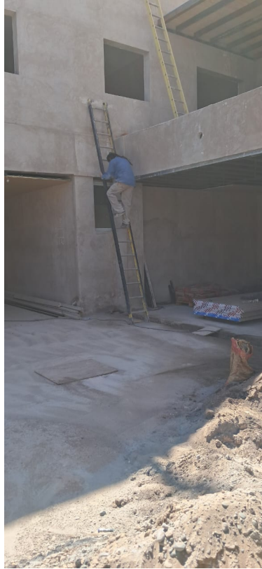
Imagen N° 5: Riesgo de caídas desde escaleras. Condición y acto inseguro de la persona. Está prohibido el uso de escaleras de madera y el traslado de materiales de un nivel a otro por las mismas. Fuente: CP/ Cassanelli Pamela, 2025.
