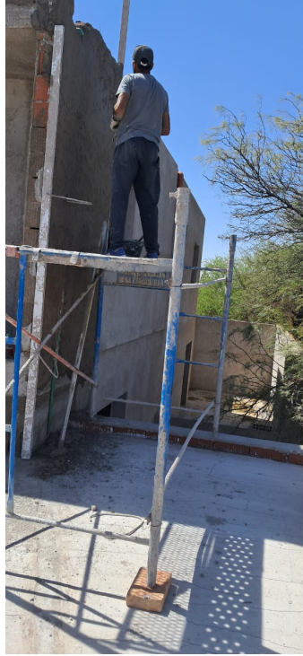
Imagen N° 3: Riesgo de caída de andamio. Andamio apoyado sobre terreno desnivelado, nivelado con ladrillo. Además, no se observa punto de sujeción, línea de vida ni arnés de seguridad, aumentando el riesgo de caída desde altura. Fuente: CP/ Cassanelli Pamela, 2025.
