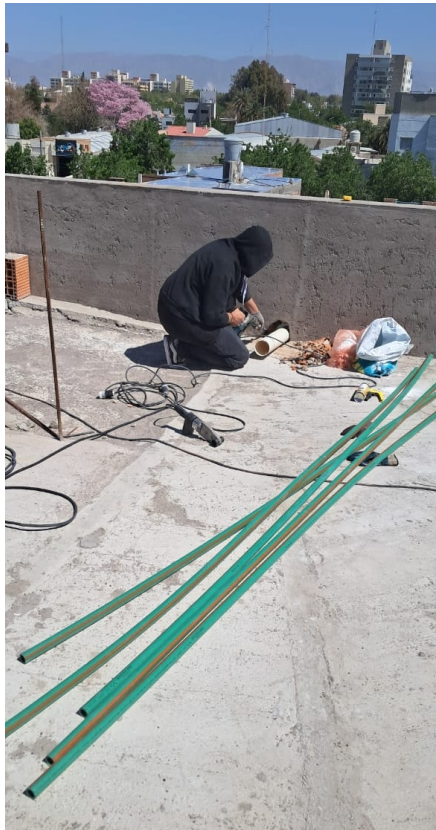
Imagen N° 7: Movimientos repetitivos. Ausencia de los EPP, ropa de trabajo inadecuada, orden y limpieza. Riesgo eléctrico. Fuente: CP/ Cassanelli Pamela, 2025.
