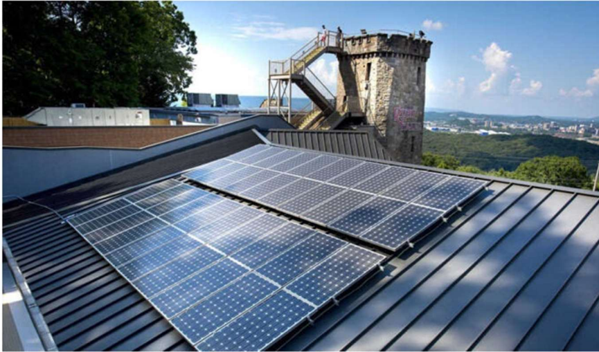
Figura 5: Paneles solares en techo de fabrica
