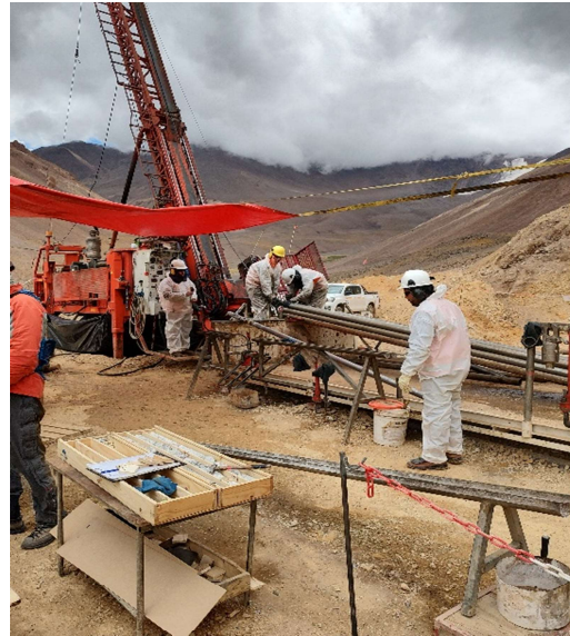
PUESTO DEL CONTROLADOR DE POZO
