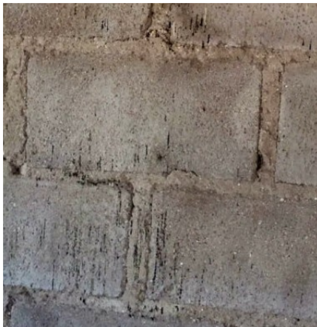
Figura 3: Materia fecal corrida en paredes
