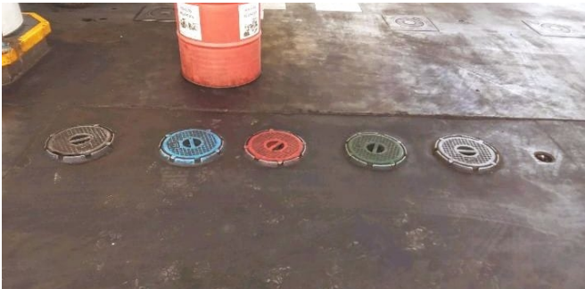
Figura N° 15: Tapas herméticas de los tanques subterráneos. Fuente: A.F. (2025)
