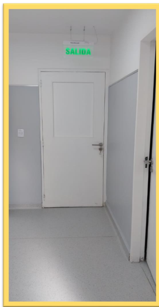
Figura N° 15: Luz de emergencia
