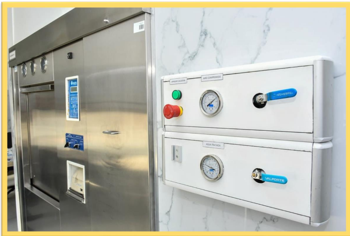
Figura N° 11: Autoclave A – Sector semicrítico
